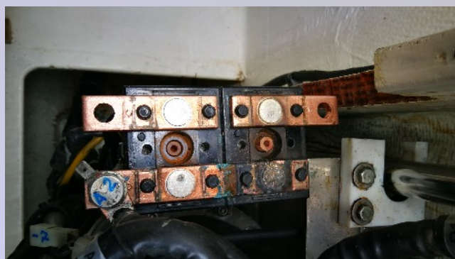
Korrodierte und abgebrannte Kontaktflächen des Bugstrahlruder-Relais
