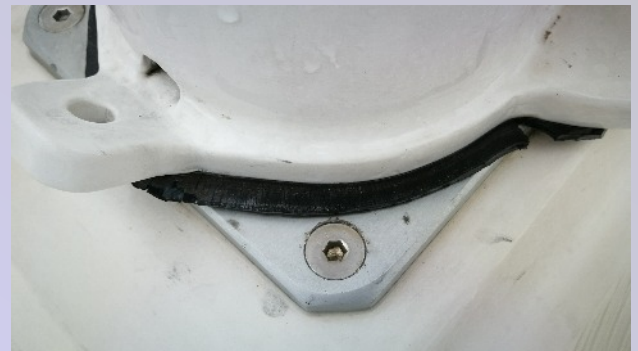
Fehler der Werft: Das zu weiche Material der Unterlegplatte wird vom Mast herausgedrückt.
